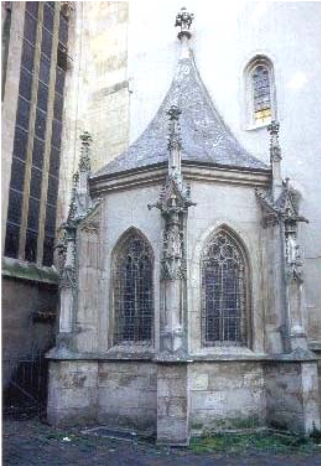
F 1 Dom Eichstätt / Chor der Kapitelsakristei Stark verschmutzte und mit Krusten überzogene Gesteinsoberflächen . Obere Bereiche, besonders die Dachfläche ist mit Grünalgen und Moos bewachsen. Zustand vor der Reinigung
