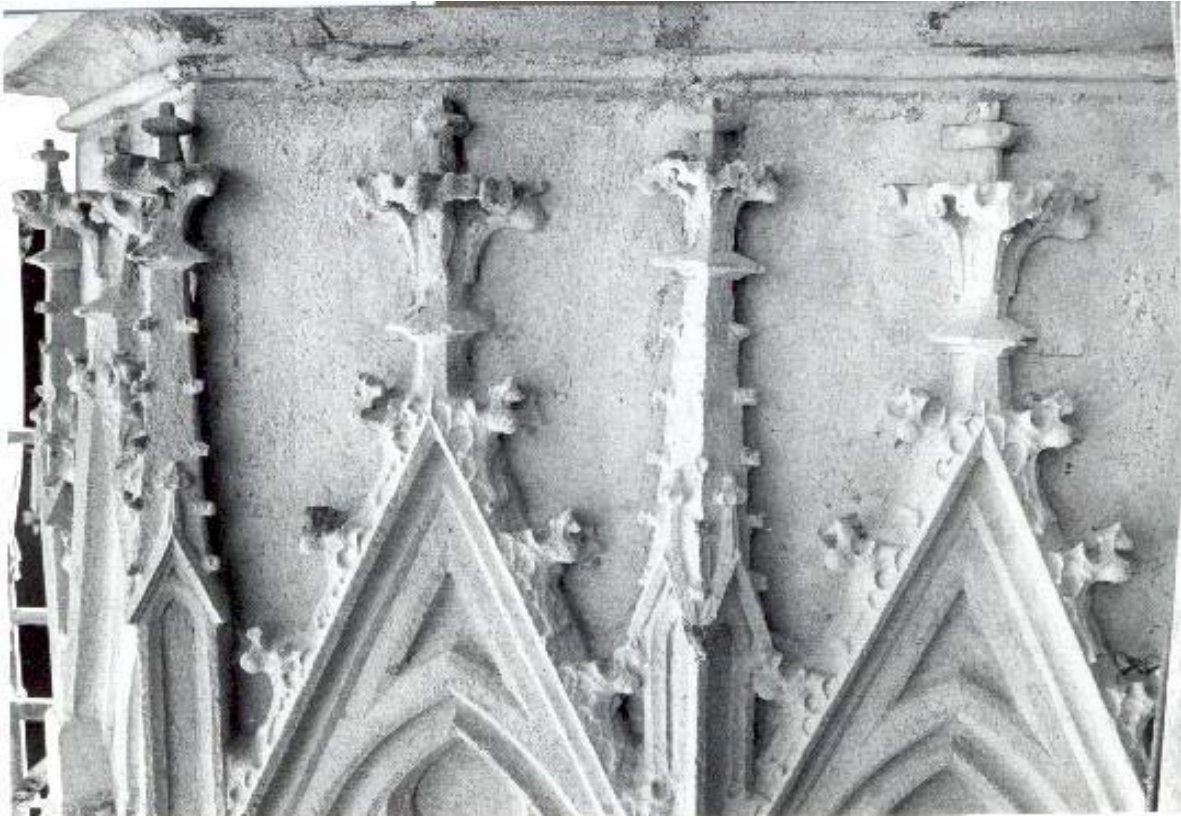
F 7 Wandfläche nach der Reinigung Die Reinigung mit dem "Vario" Wirbelstrahlverfahren wurde so sorgfältig und schonend durchgeführt, daß an den feingliedrigen Zierelementen auch keine Schäden aufgetreten und partiell sogar noch Reste einer "Patina" erhalten sind.
